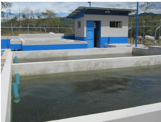
Fotografía 3: Tanques de sedimentación, planta de tratamiento. Acueducto Romakri
