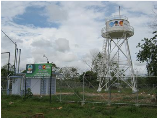
Fotografía 1: Tanques de sedimentación, planta de tratamiento. Acueducto Romakri, 23 febrero 2015
